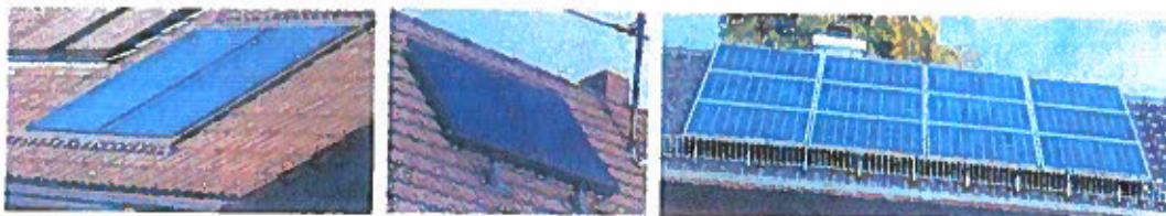
Sonnenkollektoren in .....und auf der Dachhaut
